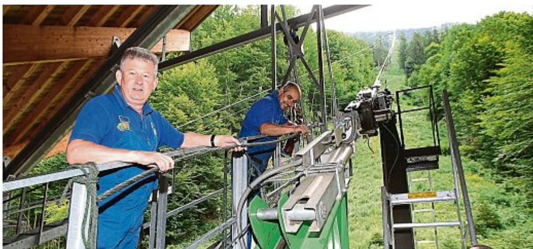
Zwei Meter, die ausgedient haben: Geschäftsführer Jörg Findeisen (vo.) und sein Mitarbeiter Bernd Heilingbrunner halten das gekürzte Zugseil in den Händen. FOTOS: PROHL
